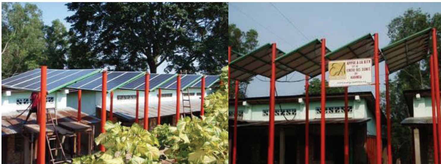
La plus grande installation de panneaux solaires de la région
