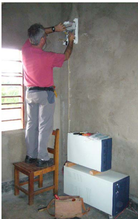
Montage van de UPS en van het ALSB
